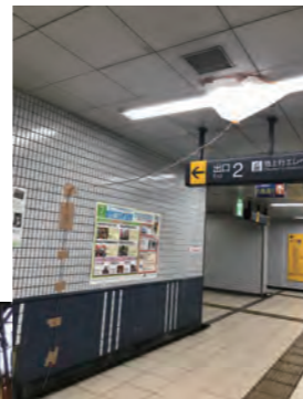
(写真上) 以前から要望のあったSR川口元郷駅構内の雨漏りについて、働きかけを行い対応をして頂く事になりました。
